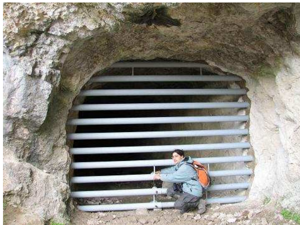
Une des 5 grilles installées dans les tunnels des Gorges du Verdon (SIC n°12) (© GCP)
