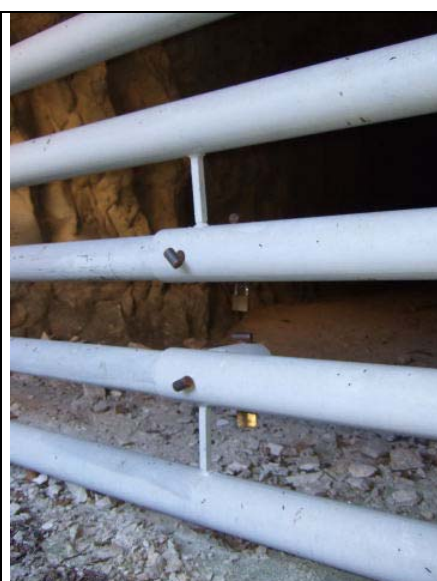
Fermeture par double clavette et guano sur les barreaux
