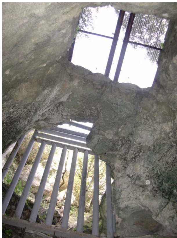
Vue intérieure de la grille verticale et du caillebotis de l'entrée inférieure
