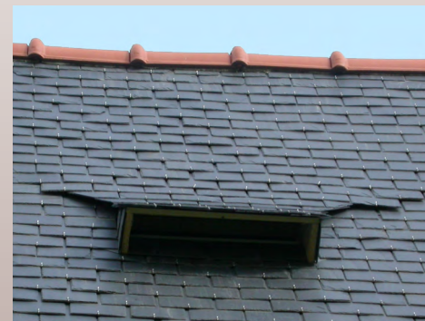
Ouverture pour les chauves-souris dans une toiture
